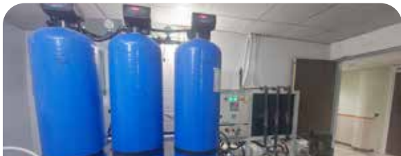
تجمیع دستگاه‌های RO در دو بخش دیالیز ۲ و ۳ (کاهش مصرف آب از ۹۰ مترمکعب به ۸۰ مترمکعب در روز)
